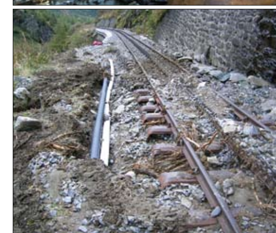
Die drei Bilder zeigen die Unterspülungen, Schutt-ablagerungen und freigelegten Leitungen auf dem Streckenabschnitt zwischen der Lammenbrücke und dem Rhoneviadukt (Oberwald-Gletsch).
