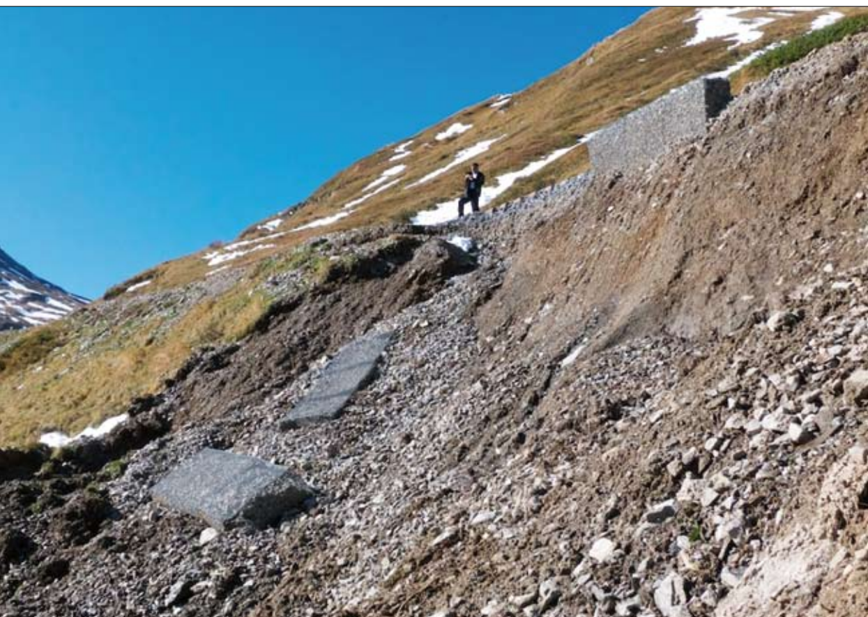
Unterhalb der Station Furka (Uri) löste sich am Gleis ein gewaltiger Murgang. Fotos: Manfred Willi, Regula Willi und Beat Moser.
